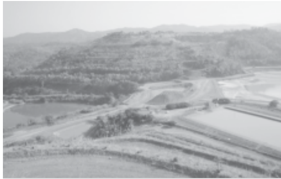
ภาพที่ 4 การฟื้นฟูพื้นที่บริเวณที่ทิ้งดินของบริษัท ผาแดงอินดัสทรี จำกัด (มหาชน)
